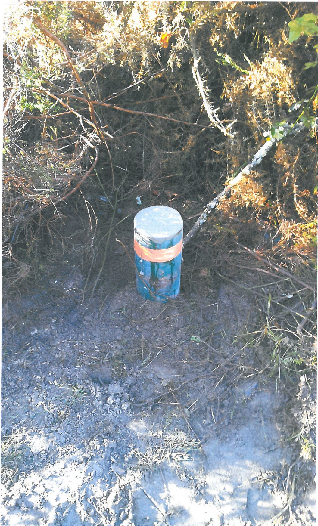
Photographie 2 : Tête de protection cimentée du piézomètre URS3
