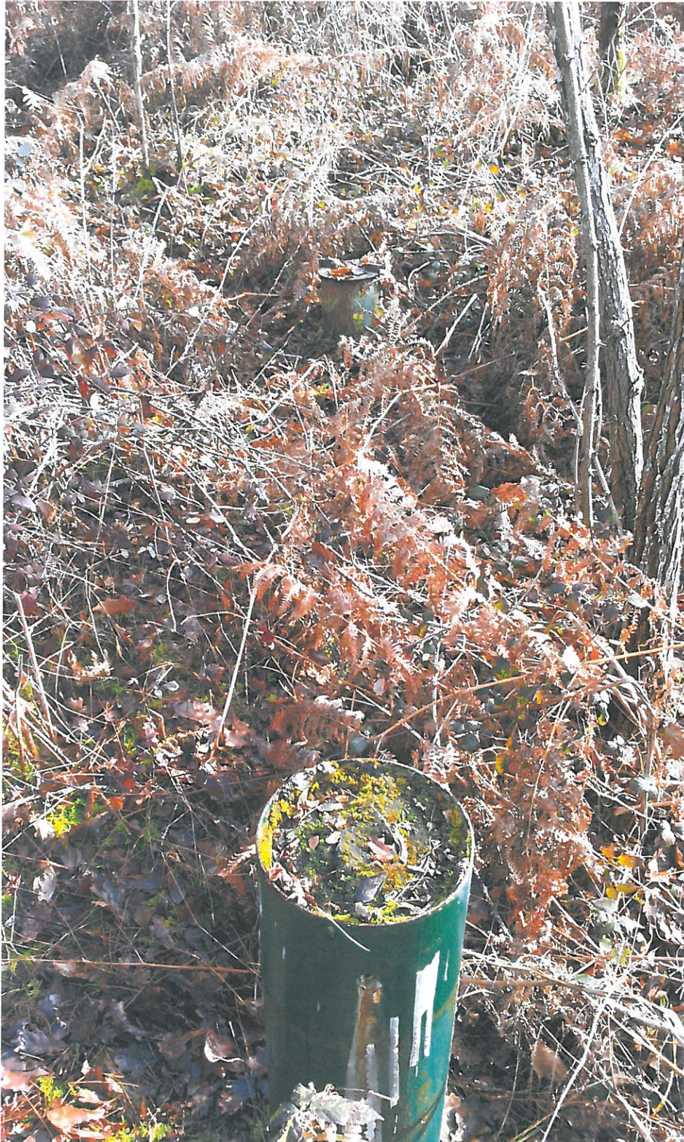
Photographie 3 : Tête de protection cimentée du piézomètre P3 et capot cadenassé de C3 (comblé)
